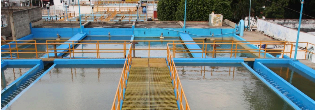
Planta potabilizadora "Villahermosa", fuente: SAS
